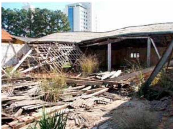
Descomissionamento da fábrica da Divisão Wagner Wall em Ponta Grossa, Paraná. Foto: Fernanda Giannasi.
